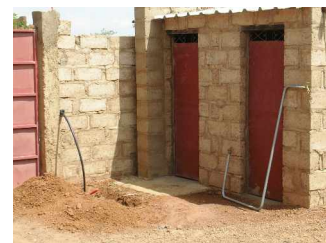
L'eau courante - branchement au raccord de la ville
